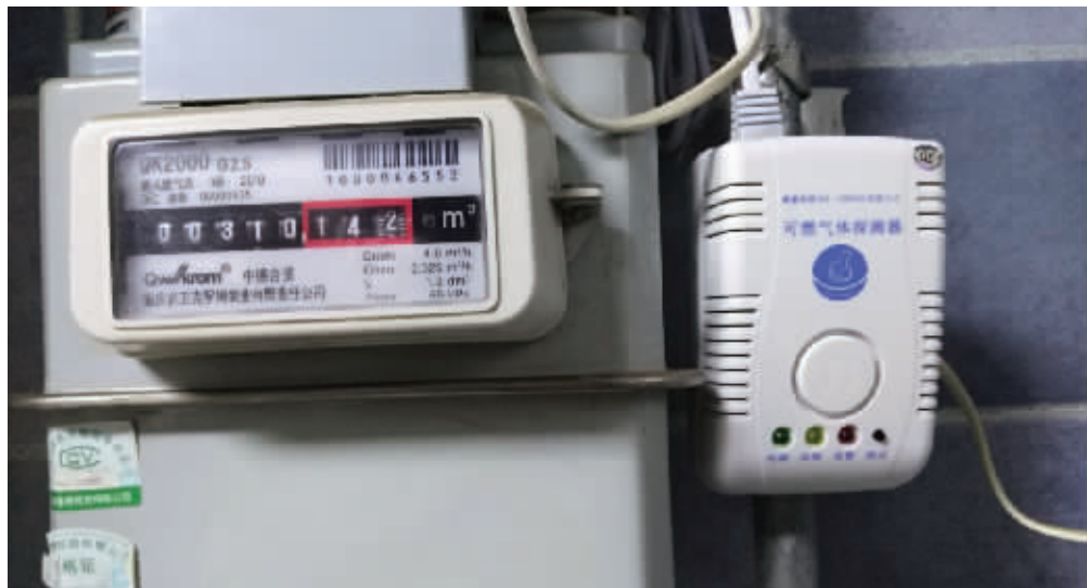
右图的“可燃气体探测器”就是郑州居民家里被骗安装的燃气报警器
